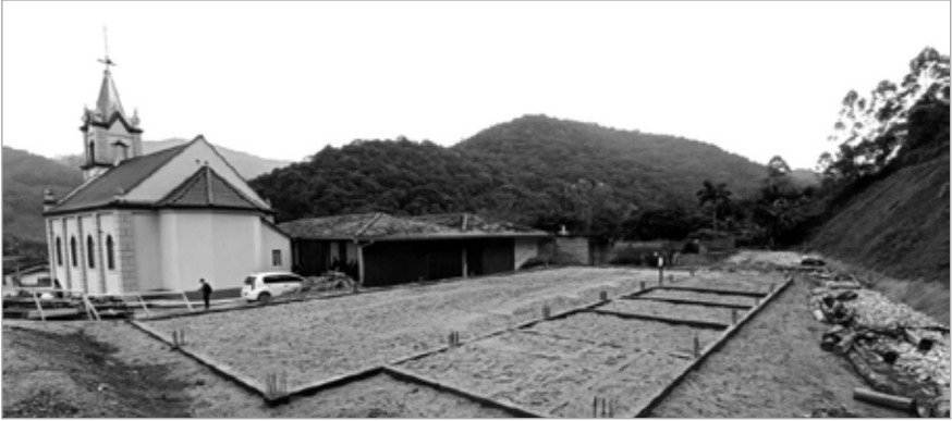
Der Baubeginn des Gemeindezentrums "Dona Martha Frehner" in Claraíba. Brasilien. Foto: Evangelische Pfarrgemeinde Lutherischen Bekenntnisses in Brusque
